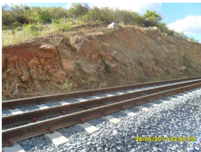
Foto 3.10 - Lote 1: Matacões soltos envolvidos por granito alterado
